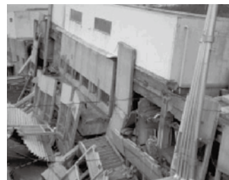
地震により半壊した工場 (福島県須賀川市)
