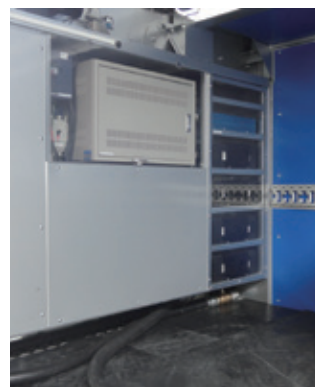
蓄電システム装置
