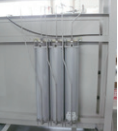
水素ガス分離タンクユニット
